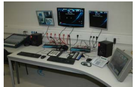
Regieraum / Leitzentrale des ETC
